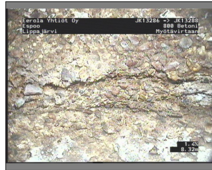
Kuva: JK13286_JK13288_030202_B.JPG, 00:00:02 0,5m, Pintavaurio, 3 Betoniputkessa kiviainesta on irronut tai raudoitus on näkyvissä 12 - 12
