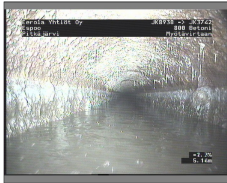
Kuva: JK8938_JK3742_014239_B.JPG, 00:00:03 0,5m, Pintavaurio, 3 Betoniputkessa kiviainesta on irronut tai raudoitus on näkyvissä 12 - 12 , Alku
