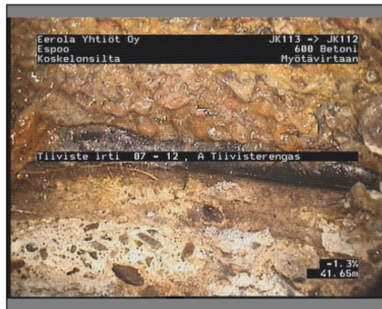
Kuva: JK113_JK112_083057_A.JPG, 00:03:45 41,65m, Tiiviste irti 07 - 12 , A Tiivisterengas
