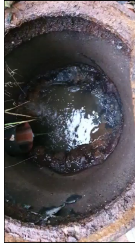
Video: Vuotava kaivo JK9208 Lippajärven pohjoispuolella
