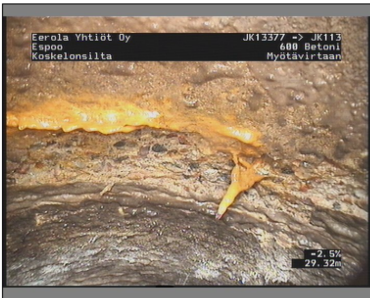
Kuva: JK13377_JK113_081753_B.JPG, 00:02:43 29,37m, Vuoto Klo. 12 , 2 Veden tippuminen
